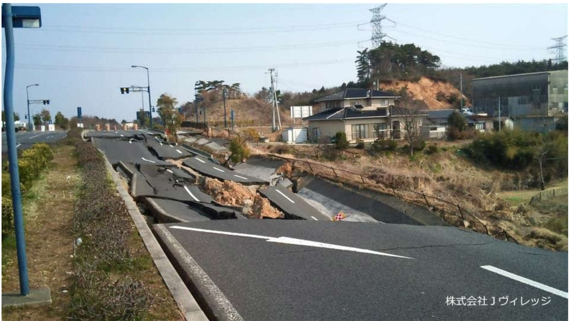
地震により寸断された道路
