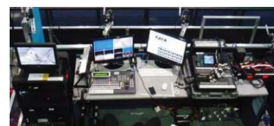
コントロールシステム
