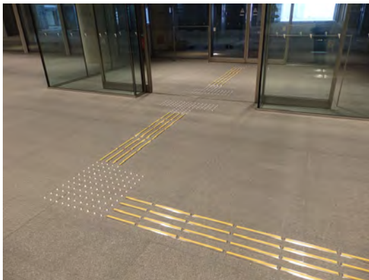
写真 9.1.14-9 線状ブロック
