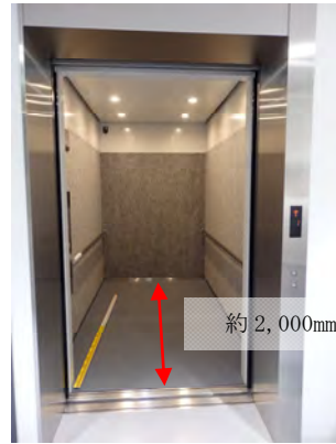
写真 9.1.14-6 車椅子利用が可能なエレベーター
