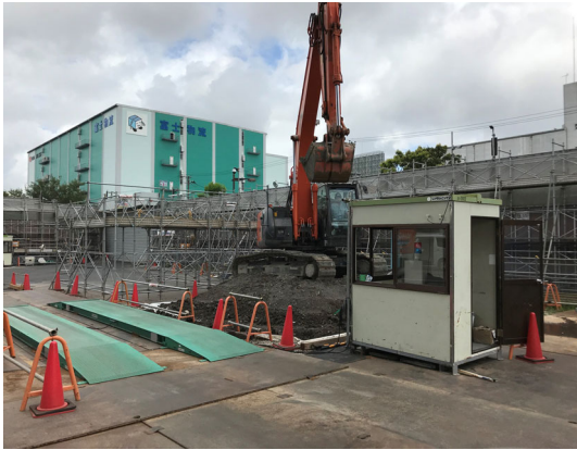
写真 8.1-7 トラックスケールによる計量
