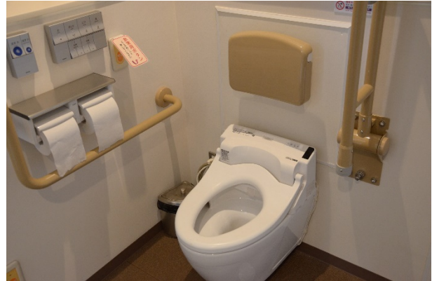
(東京都撮影) 節水型トイレ (大井ホッケー競技場)
