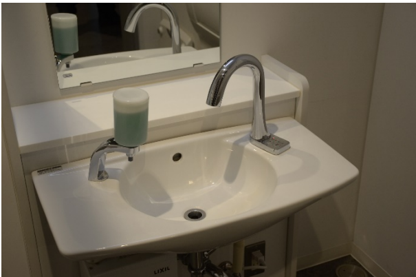
(東京都撮影) 自動水栓 (武蔵野の森総合スポーツプラザ)
