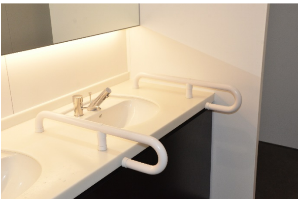
(東京都撮影) 自動水栓 (有明アリーナ)
