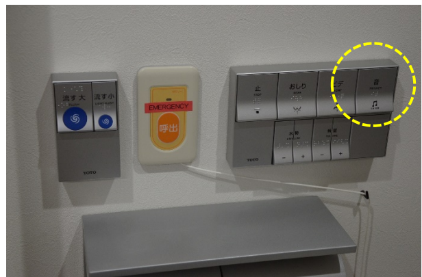
(東京都撮影) 擬音装置 (カヌー・スラロームセンター)
