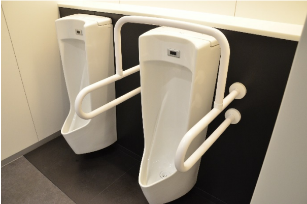
(東京都撮影) 節水型トイレ (有明アリーナ)
