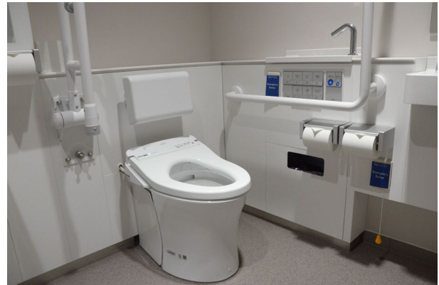
多機能トイレの設置
