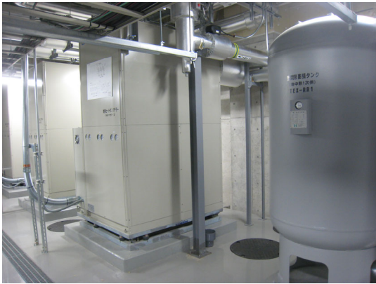
地熱ヒートポンプチラー
