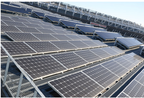
太陽光発電設備
