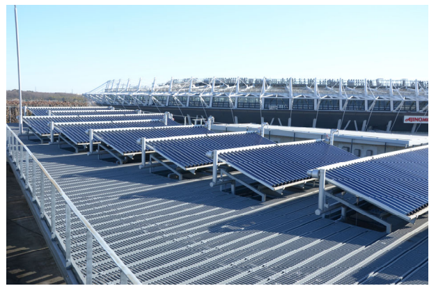
太陽熱利用設備
