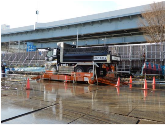
写真 8.5.1-1 タイヤ洗浄設備
