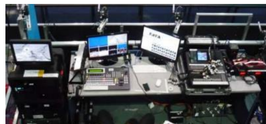
コントロールシステム
