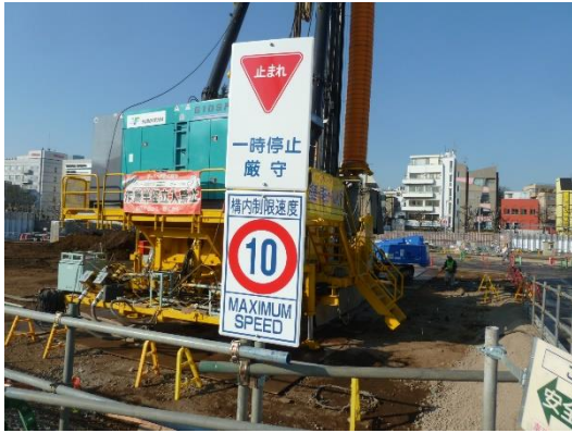
写真 8.7-1 場内規制速度の掲示
