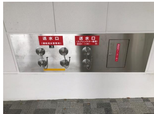
写真 8.22-4 本格消火設備
