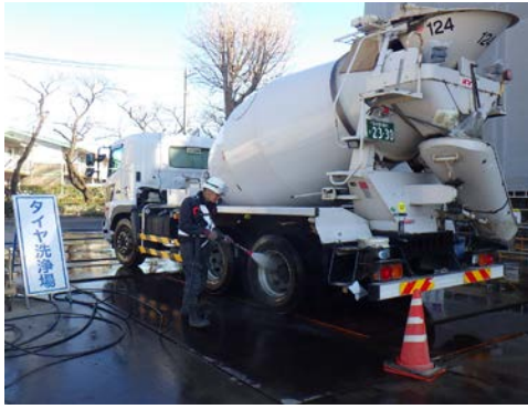
写真 8.1-1 タイヤ洗浄設備
