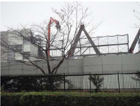
写真 8.1-13 パネル+防音シート
