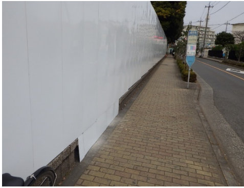
写真 8.5-7 北エリア地下道スロープ施工範囲における鋼製仮囲い (3m)
