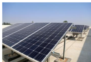
<太陽光発電設備> [6]
